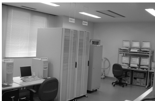
テレメータシステム(親局装置及び処理系サーバと操作端末)
