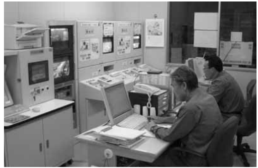
図 7 RI 管理室 作業員の全面に連続照射装置とガンマシミュレータの操作盤、各種監視盤が設置されている。
