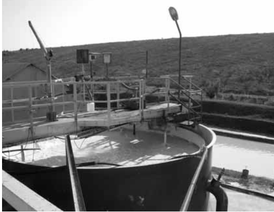
図4 地下水の処理場の様子
