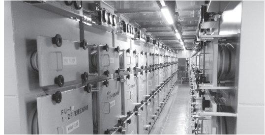
写真14 排気フィルターユニット
