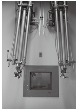
操作室側より撮影
