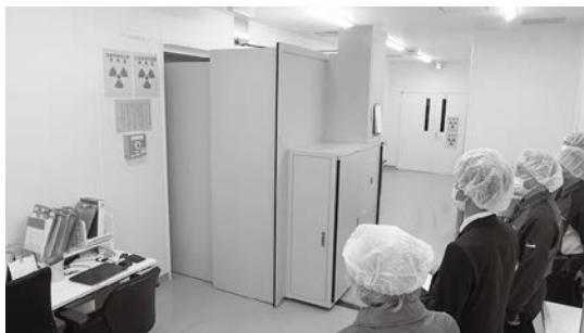
写真5 サイクロトロン室 入口
