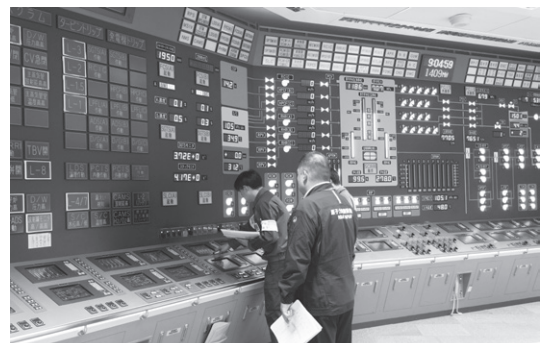
柏崎刈羽 6号機中央制御室
